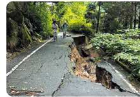
林道の路体崩落 (唐津市)
